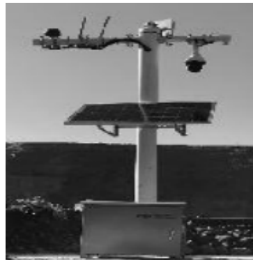
图 8 地面系统中的路侧单元实物图
